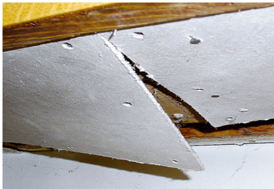
Pannelli leggeri contenenti amianto
